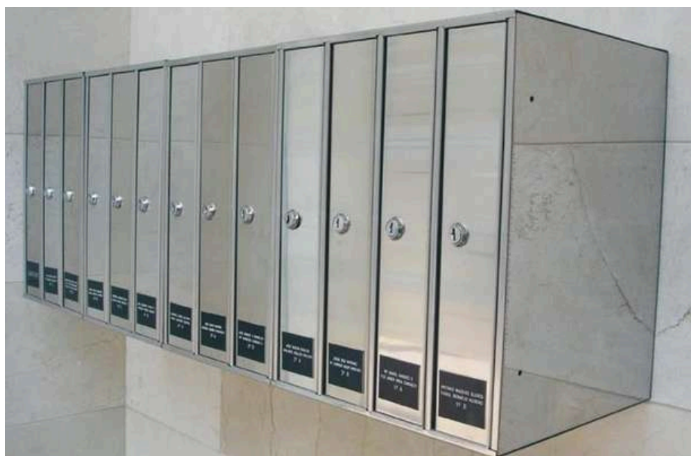
Buzón top todo inox. instalado.
