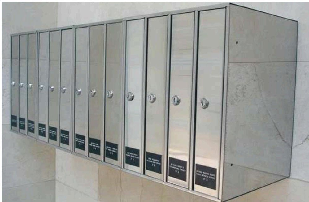
Buzón top todo inox. instalado.
